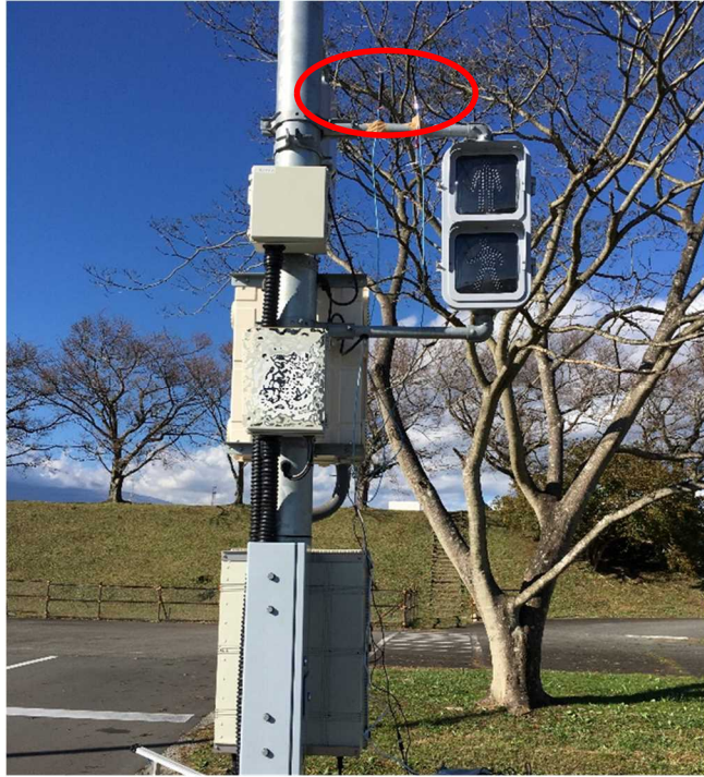
図 3.4.1-5 信号柱 A (赤丸に無線機アンテナを示す)
