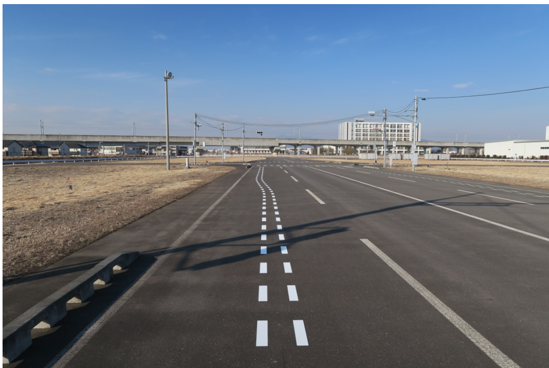
図 5-4 誘導線②（白）設置状況
