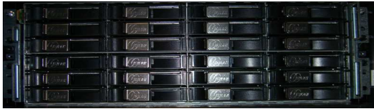
筐体前面に HDD 24 基
